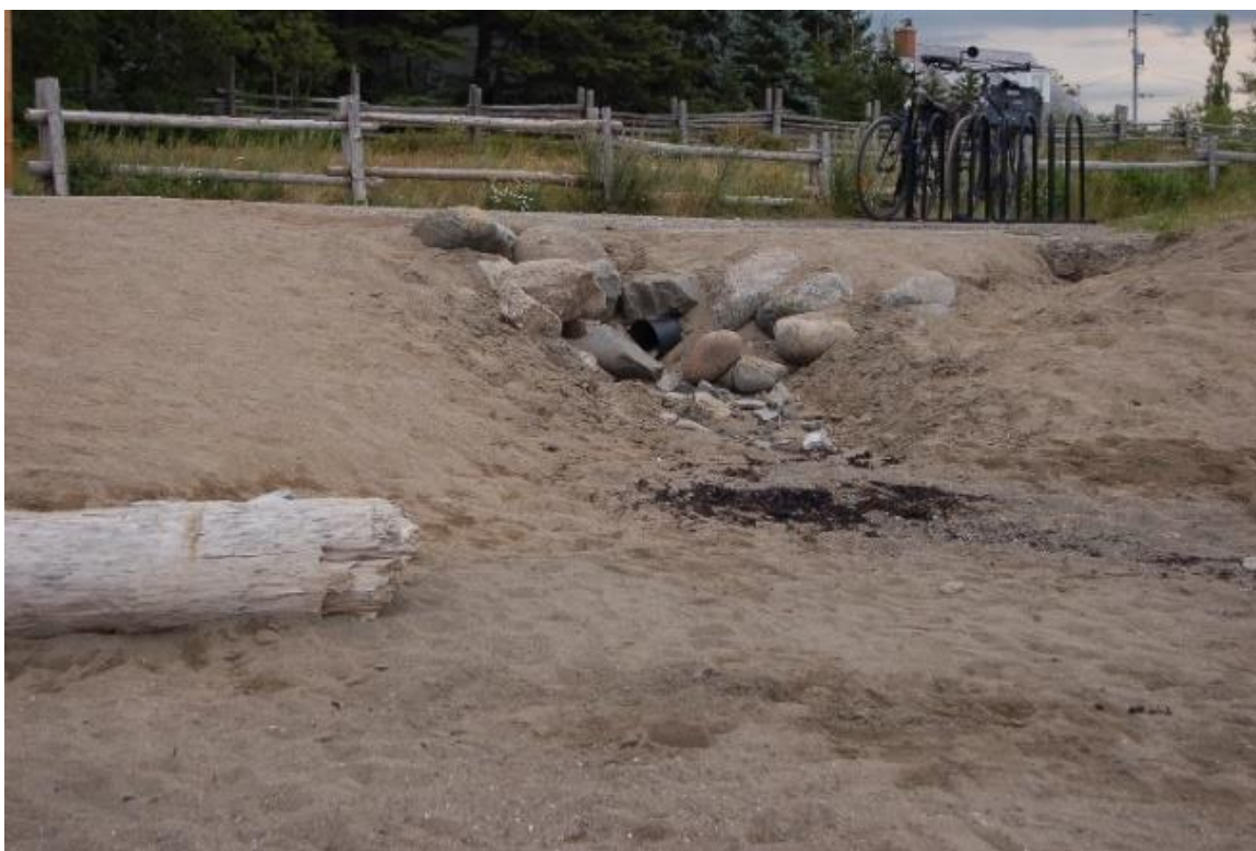
Figure 21 : Sortie d'un tuyau de drainage sur la plage de la route de la Pointe-aux-Anglais.
